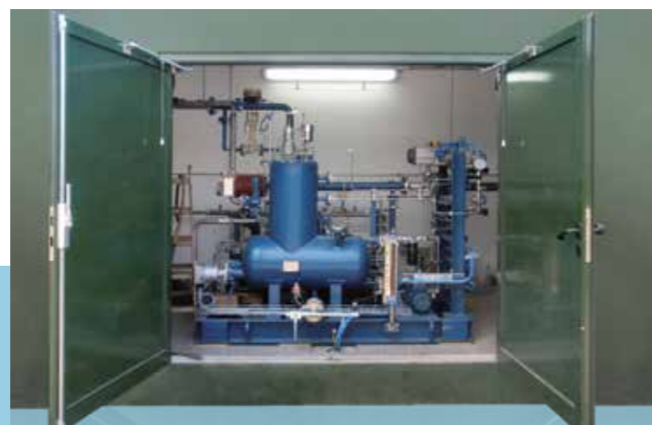
Sprężarka AERZEN VMX 110 do tłoczenia biometanu
