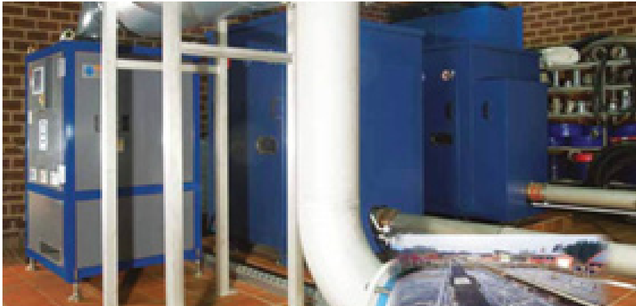
Dmuchawa Turbo AERZEN AT i dwie dmuchawy rotacyjne do napowietrzania i oczyszczania ścieków w Bremervörde, Niemcy.
