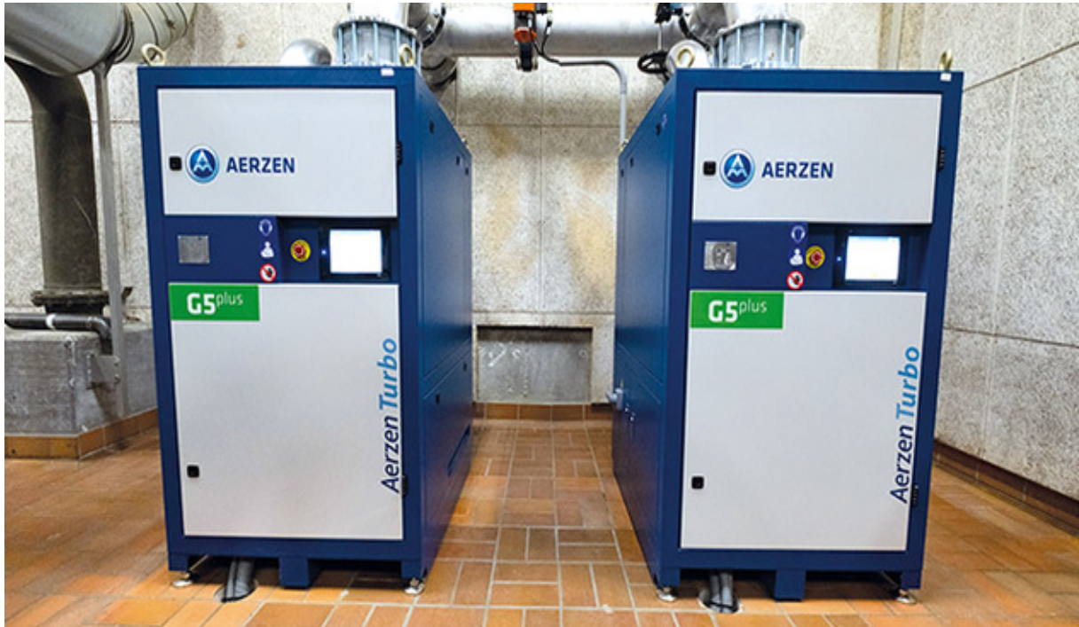
Zapotrzebowanie na tlen zapewniają dwie turbodmuchawy AERZEN
